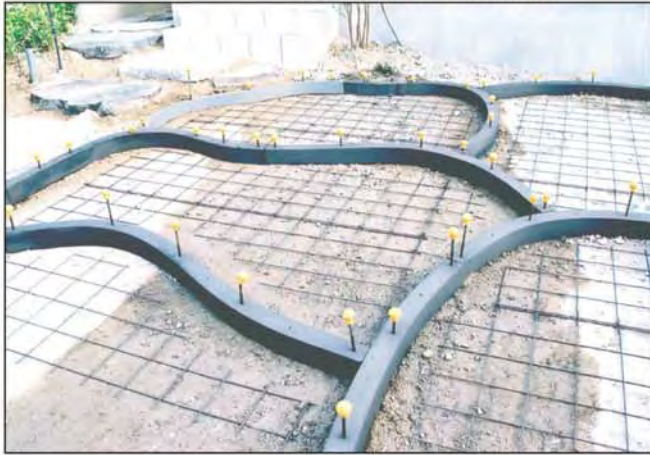
↓ ③ 設置完了。(安全キャップを着けることにより 事故防止をはかる)
